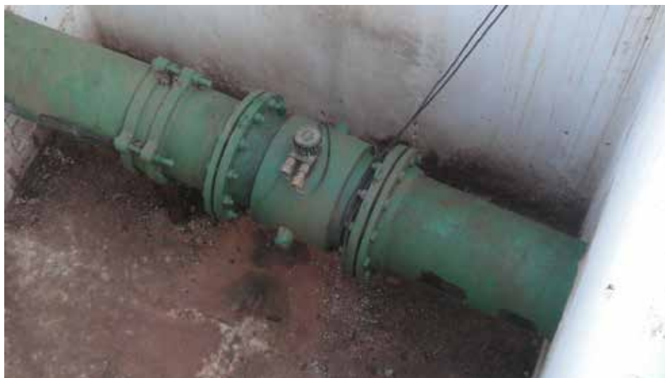
Figura 8. Medidor de vazão eletromagnético de Campo Grande.
